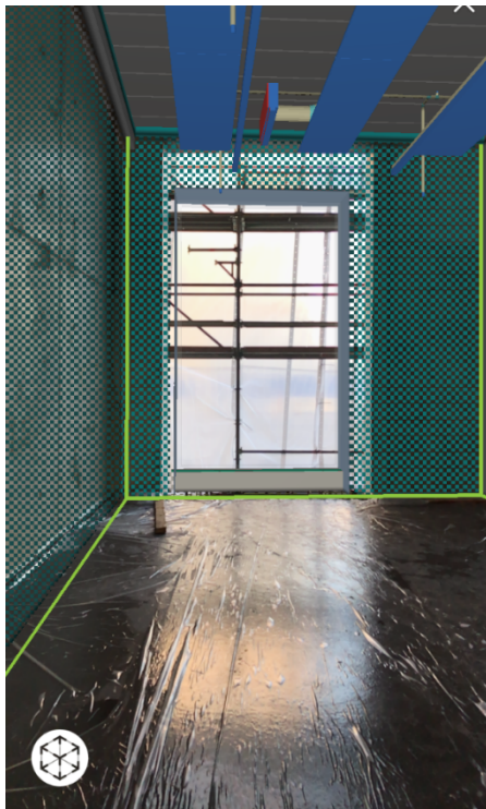
Kuva 17: Lisätyn todellisuuden käyttöä talotekniikan asennusten havainnollistamisessa
